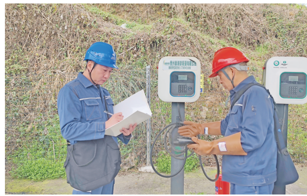
3月12日,习水供电局对县域内充电桩设备、供电线路及配电箱进行检查,确保充电桩安全稳定运行,为居民“绿色”出行保驾护航。
